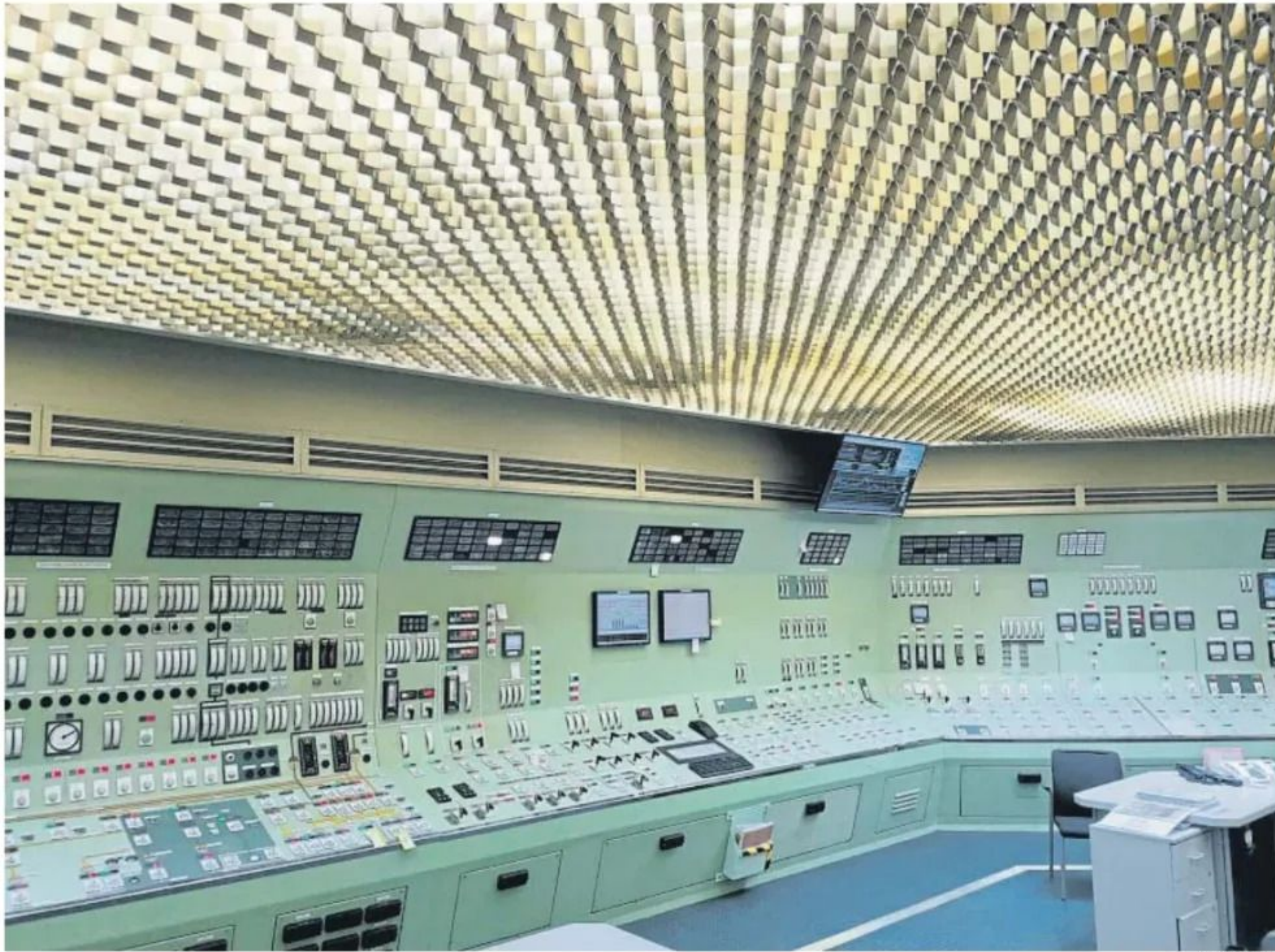
Sala de control de la central nuclear de Almaraz, Cáceres
